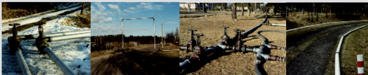
Urządzenia i elementy rurociągu polowego w terenie
