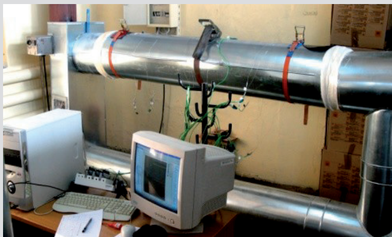
Stanowisko do badań izolacji termicznej ciepłociągów firmy Eurico Polska
